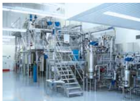
Modulare Bauweise im Skidsystem
