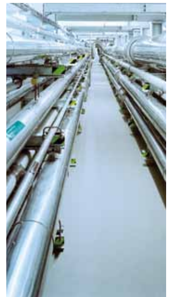
Anlage zur Wirkstoffherstellung, Infrastrukturplanung
